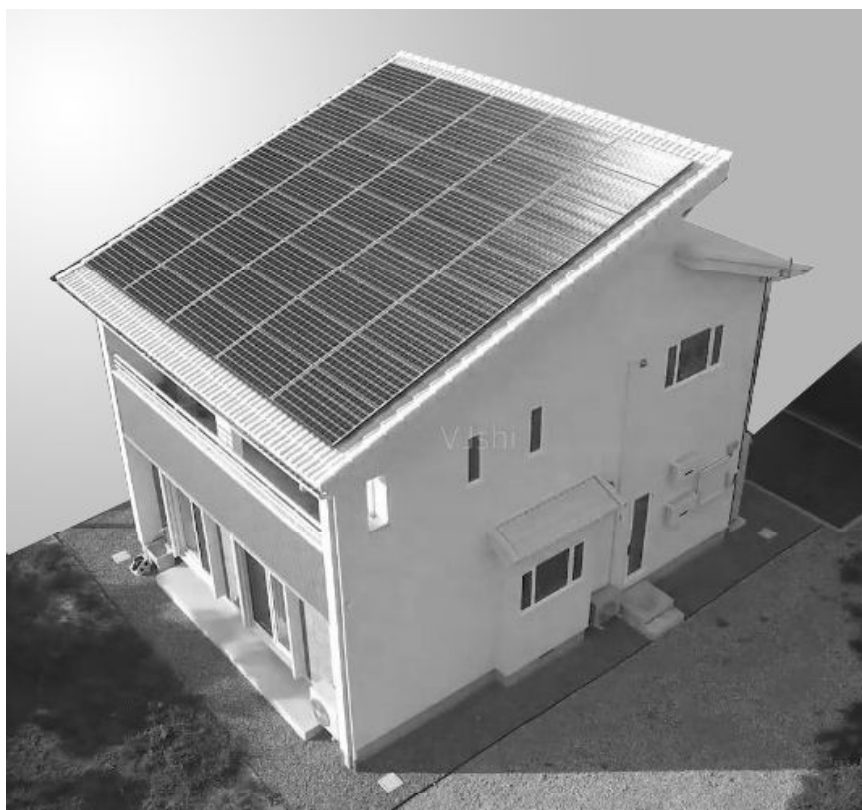
图 1 房屋光伏系统
