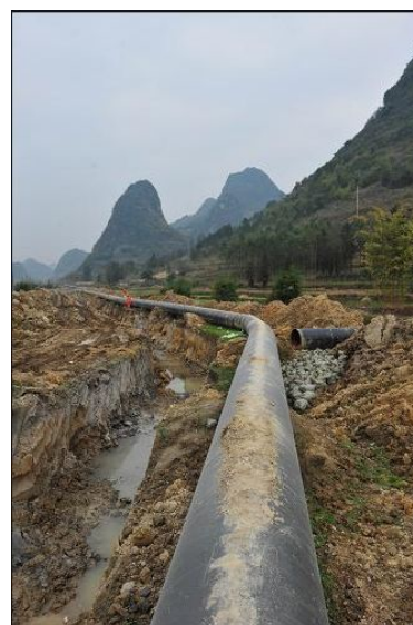
图1 某油气管道腐蚀
