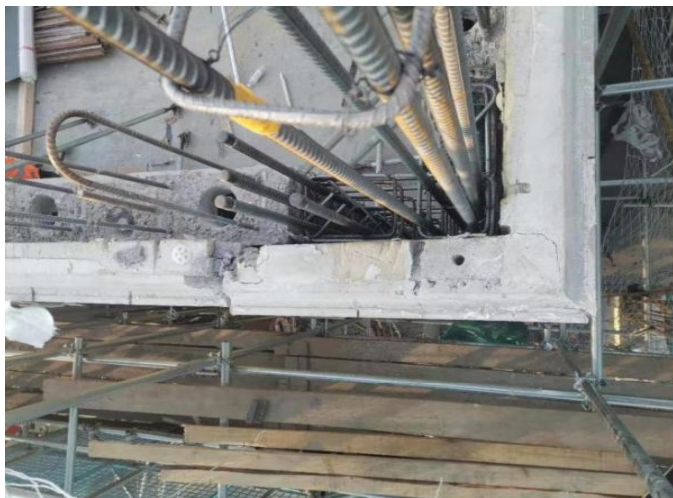
图 2 外叶板外飘变形实例
