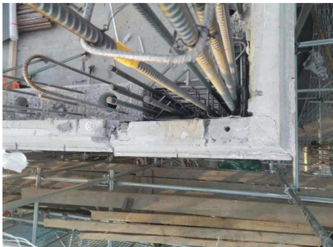
图 2 外叶板外飘变形实例
