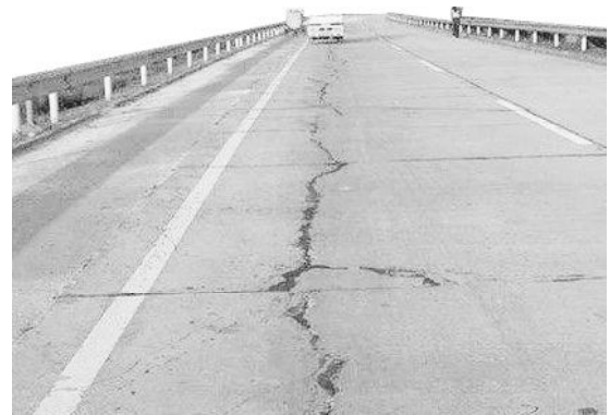
图1 道路施工裂缝
