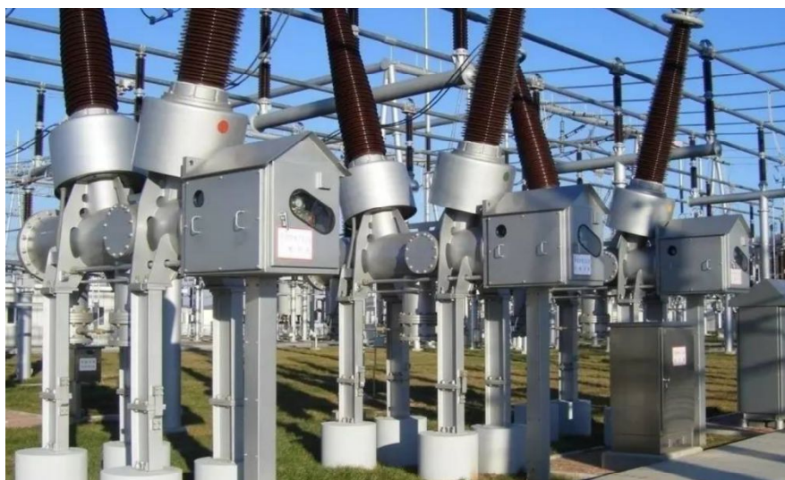
图1 户外变电站断路器
