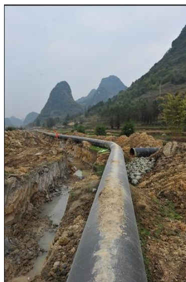
图1 某油气管道腐蚀
